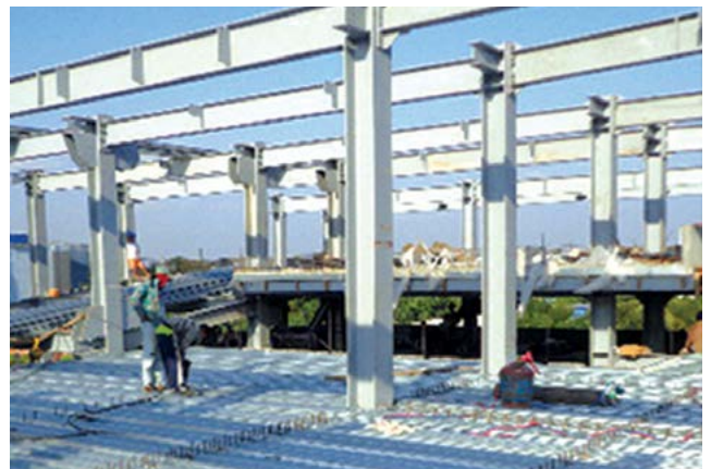
DẦM THÉP LIÊN HỢP VỚI SÀN BÊ TÔNG, TẦM SÀN VÀ ĐÍNH NEO COMPOSITE DESIGN WITH STEEL DECK AND SHEAR STUD
