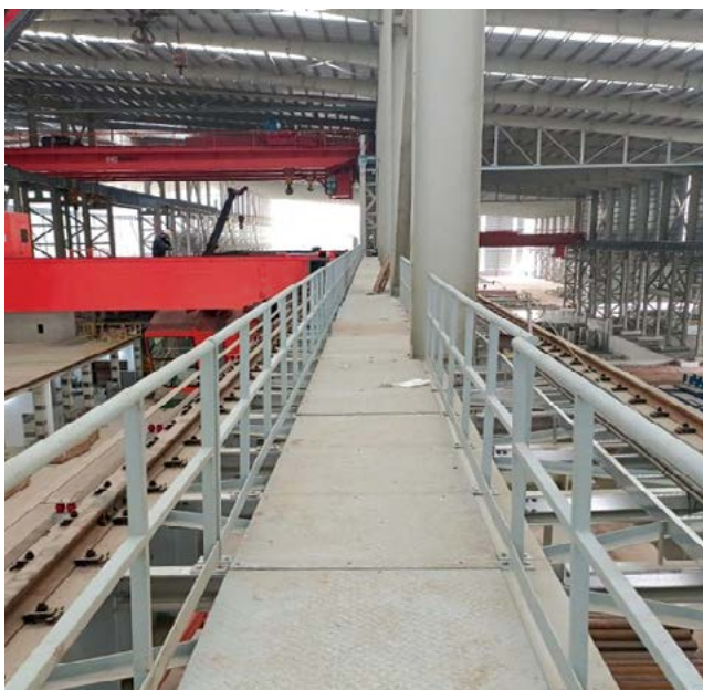
LỐI ĐI GẮN CỘT KHUNG CỨNG CATWALKS AT RIGID FRAME COLUMN
